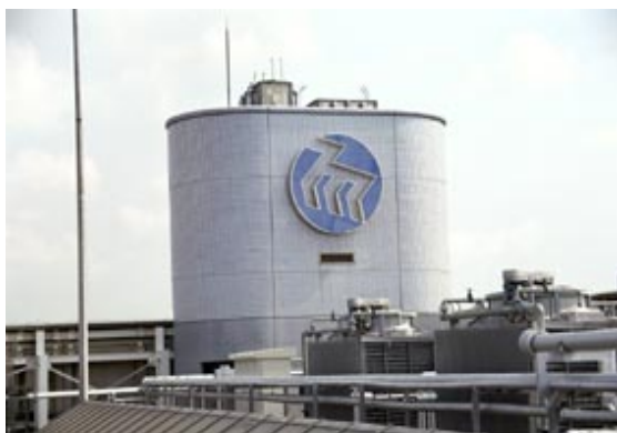
本社屋上に設置されている中水(雨水)塔
