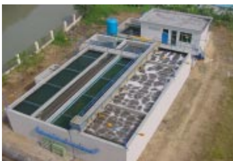
広東マブチ第一工場に建設された下水処理施設
