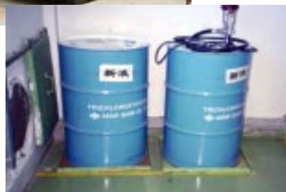
全てのトリクロロエチレン液入りのドラム缶の下に、漏れ防止用パンを設置 (江蘇マブチ)
