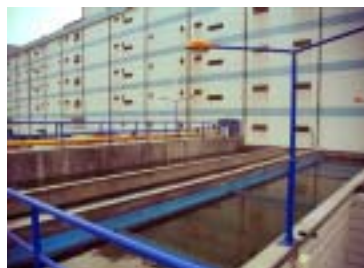
広東第一工場に建設された排水処理施設 (香港マブチ)
