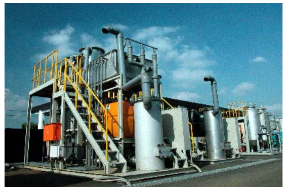
マブチモーター新本社構内に設置されている、地下水浄化施設
