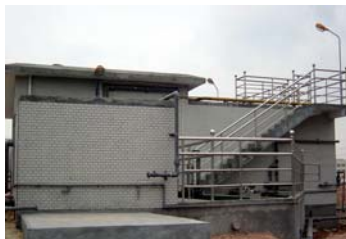
2004.8 竣工した東莞マブチに建設された、200 t / 日処理能力を有する排水処理施設
