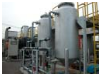
本社に設置してある土壌浄化施設
