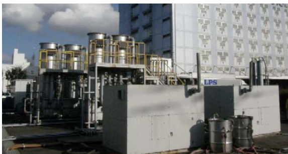
敷地内に設置している地下水浄化装置(本社)
