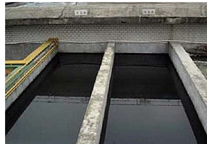
排水再利用沈殿槽
