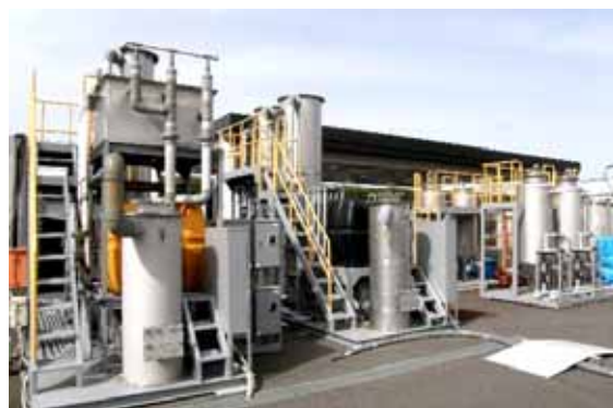
本社敷地内に設置された土壌浄化装置
