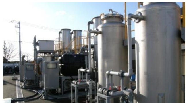
本社敷地内に設置された土壌浄化装置
