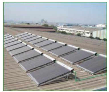
屋上に太陽熱温水器を設置し、 工場内給湯器湯沸しに使用する ガスの使用量を削減 (ベトナムマブチ)
