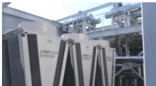
新たに導入した24H系熱源供給機（本社／技術センター）
