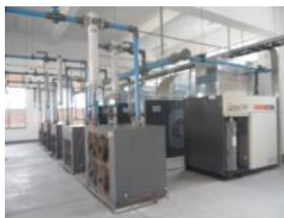
自動制御コンプレッサーシステム
