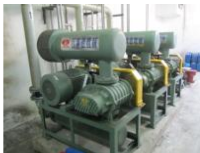
工場内に設置された污水处理設備
