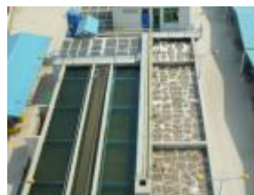
排水浄化処理施設
