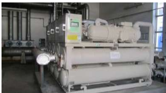
新型冷凍機（大連・瓦房店マブチ）
