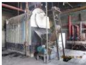
集中供熱システムを導入前のボイラー室（瓦房店マブチ）
