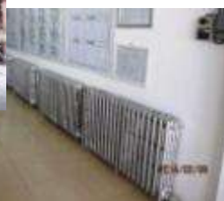
集中供熱システムを利用した後の工場内
