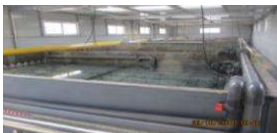
下水処理システム（瓦房店マブチ）
